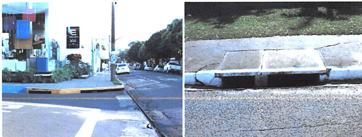
Foto 52 e 53 – Sarjetas, Meios-fios e Bocas de lobo existentes em ruas de Birigui
