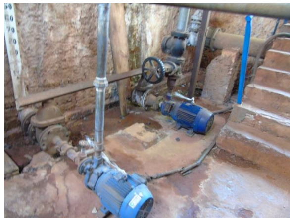
Foto 22 – Conjunto de bombas
