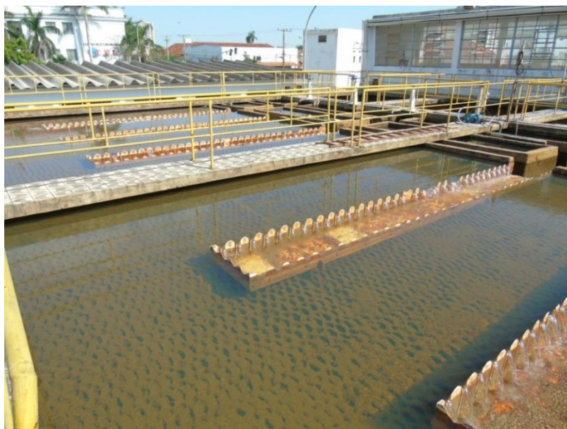
Foto 10 – Sistema de decantação
