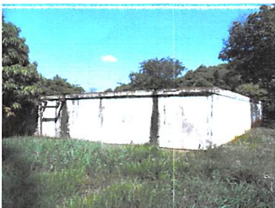
Foto 21 – Reservatório Semienterrado Fonte: PROJEC (2015)
