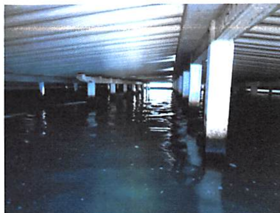
Foto 19 – Reservatório semienterrado Fonte: PROJEC (2015)
