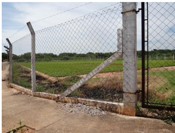
Foto 51 – Antigo Bolsão de entulho totalmente cercado
