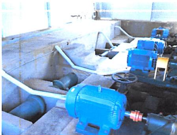
Foto 5 – Conjunto de bombas Fonte: PROJEC (2015)
