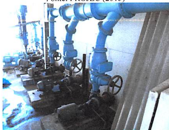
Foto 25 – Conjunto elevatório Fonte: PROJEC (2015)
