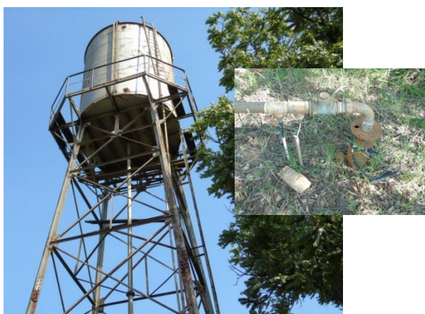
Foto 33 - Poço Taquari e Reservação Fonte: PROJEC (2015)
