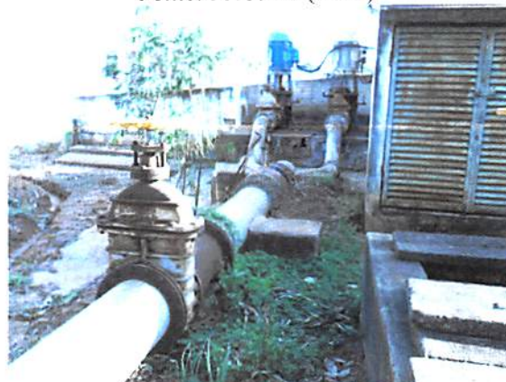
Foto 20 – Conjunto elevatório Fonte: PROJEC (2015)
