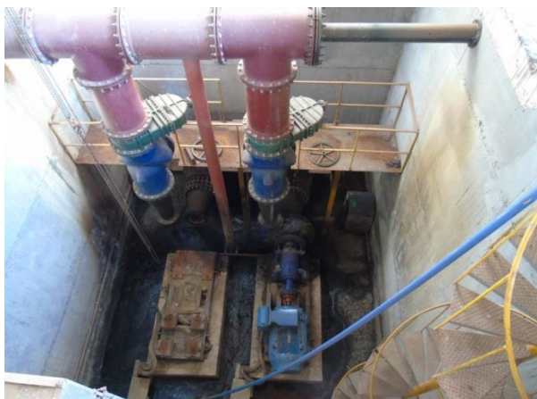
Foto 38 – Bombas para recalque Fonte: PROJEC.
