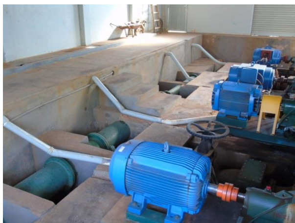
Foto 5 – Conjunto de bombas Fonte: PROJEC (2015)
