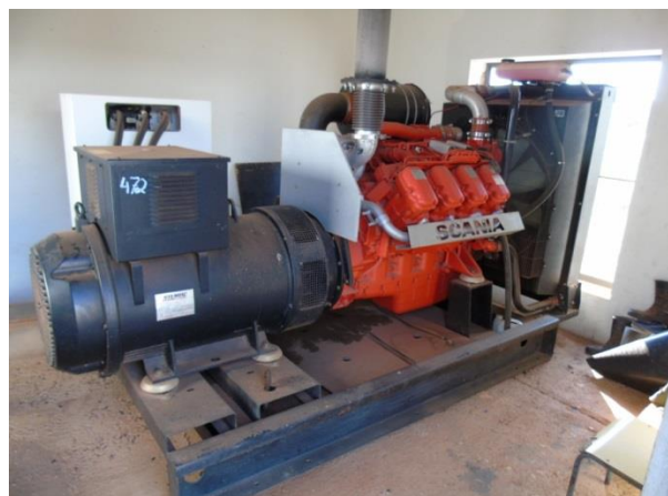
Foto 39 – Gerador de energia Fonte: PROJEC.
