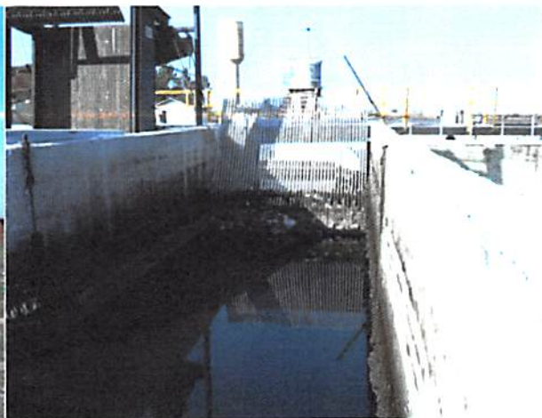
Foto 35 – Grade metálica para remoção de sólidos Fonte: PROJEC.
