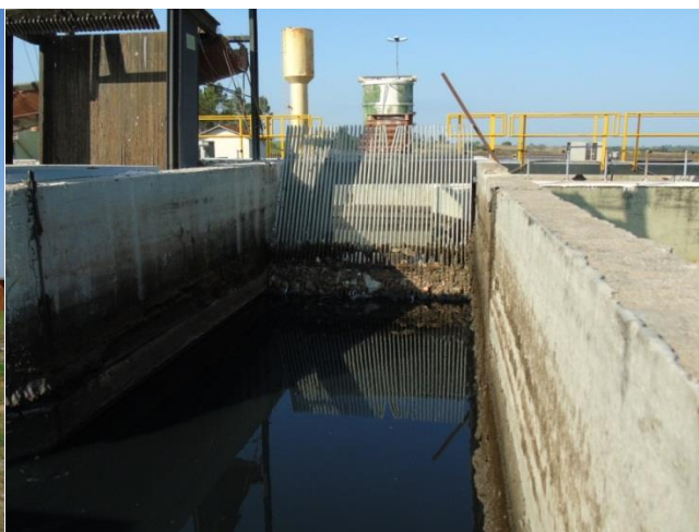
Foto 35 – Grade metálica para remoção de sólidos
