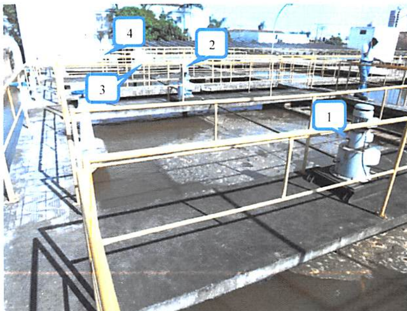
Foto 9 – Sistema de floculadores
