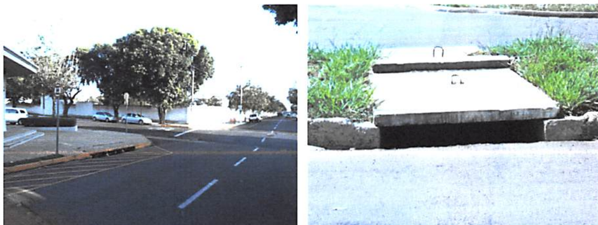
Foto 54 e 55 – Sarjetas, Meios-fios e Bocas de lobo existentes em ruas de Birigui
