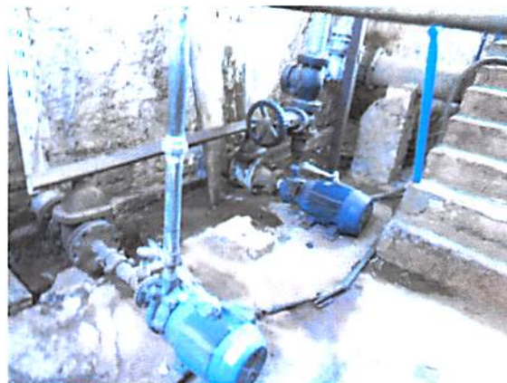
Foto 22 – Conjunto de bombas Fonte: PROJEC (2015)
