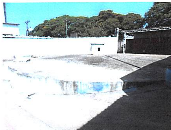
Foto 24 – Reservatório semienterrado Fonte: PROJEC (2015)
