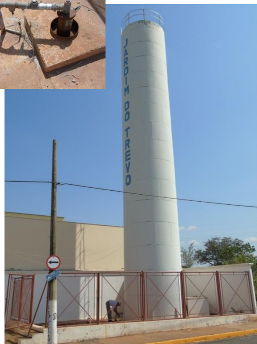
Foto 27 - Poço Jardim do Trevo e Reservação
