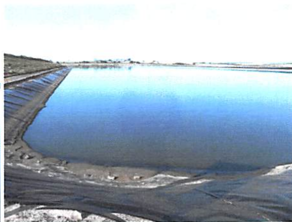
Foto 37 – Lagoa Facultativa Fonte: PROJEC.
