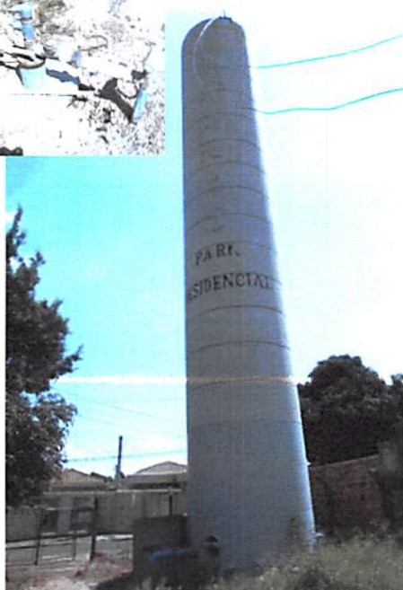
Foto 28 - Poço Colinas I e Reservação
